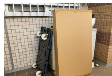
▲室外機周辺障害物ありの状態
