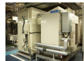
臨海工場に設置した「JIZAI HEAT」
