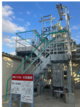
フロン再生設備
