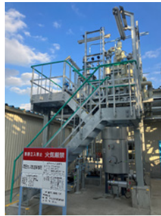
フロン再生設備
