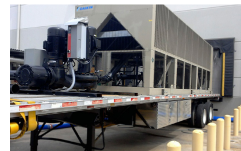
テキサス州のデータセンターに設置される空冷式チラー。
