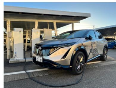
マツモトプレジジョン株式会社に設置されたEVおよび充電器
