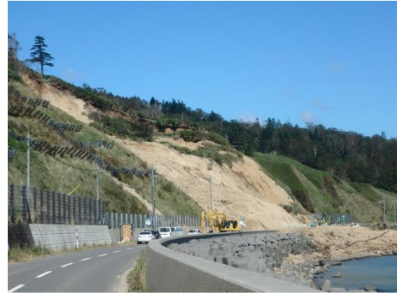
北浜地区の土砂崩れの様子
