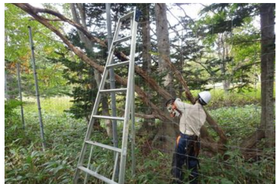
写真 1-4. 柵に倒れこんだ倒木の除去作業（2018 年 9 月 30 日）。
