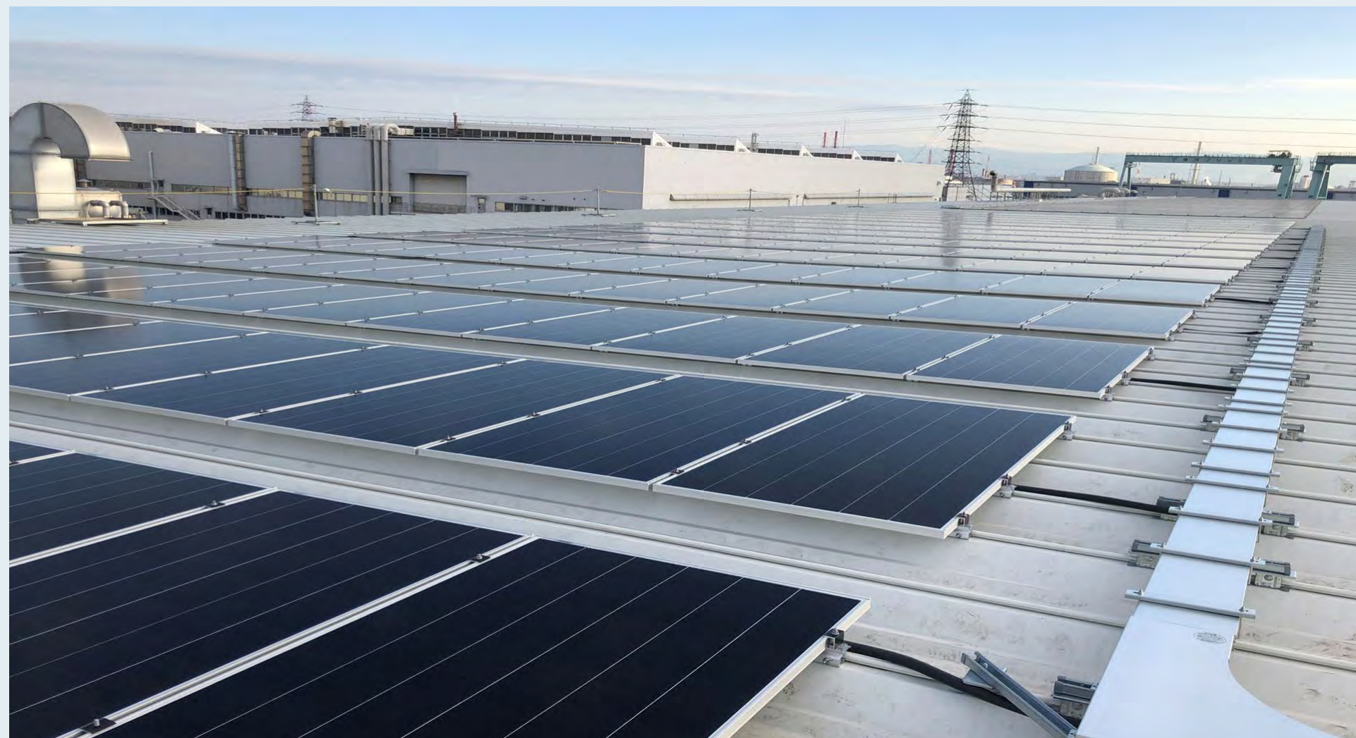
臨海 1号工場屋上 太陽光パネル
