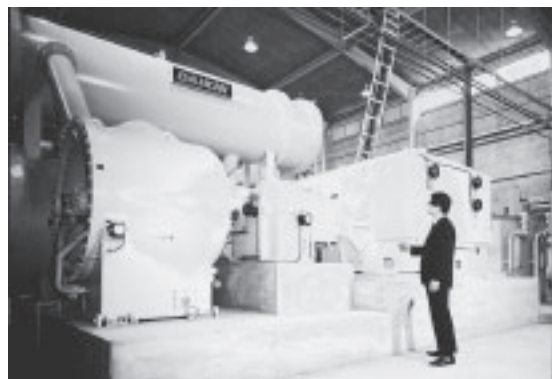
3000 冷凍トンのターボ冷凍機 (1970 年 3 月)
