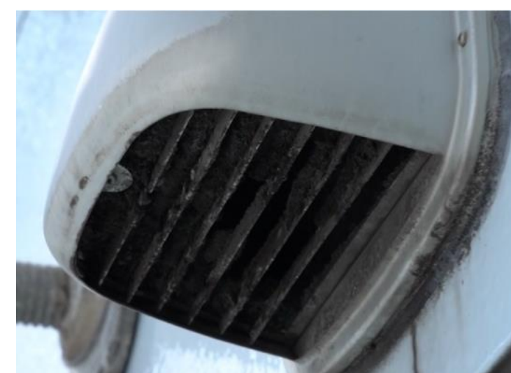
外壁の換気口の汚れ
