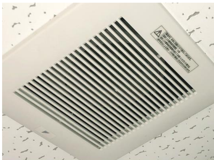
天井の換気口の汚れ
