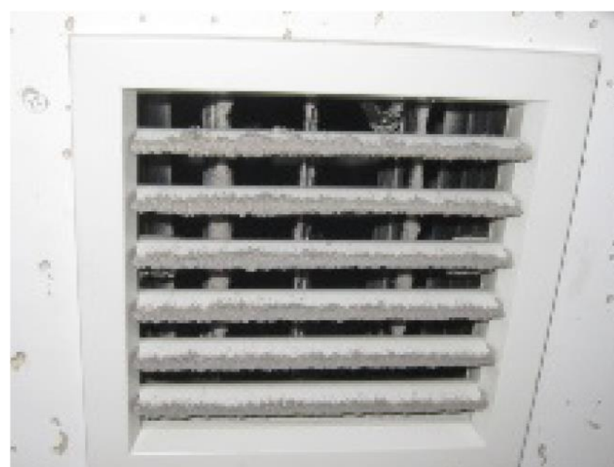
換気口（排気口・給気口）の汚れ
