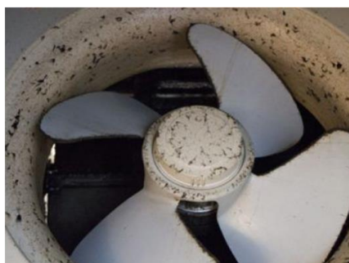
換気扇の汚れ
