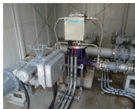
DK-Powerの水力発電設備
