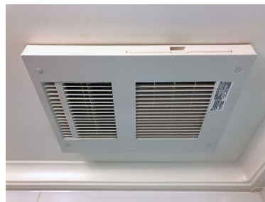
浴室の換気口例
