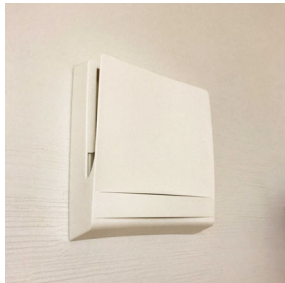
壁の換気口例①
